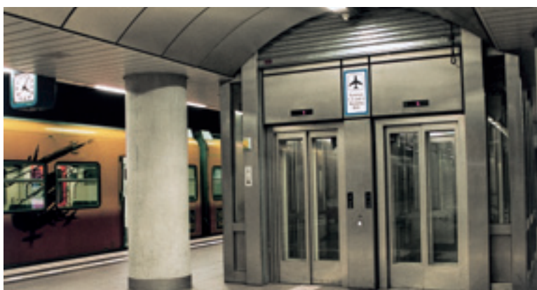
Bahnhof (Abschottung der Aufzugsanlage)
